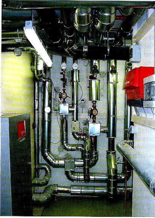
Blick in die Heizzentrale Mulackstraße: Das Gebäude wird mittels einer 32,6 kW- Wärmepumpe beheizt.
